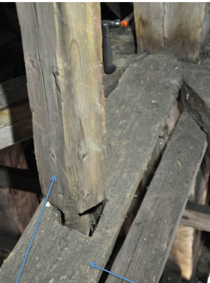
Sparre helt utan bärighet då underliggande bjälke har glidit av sitt bärande upplag och nära att trilla ner på klockorna
