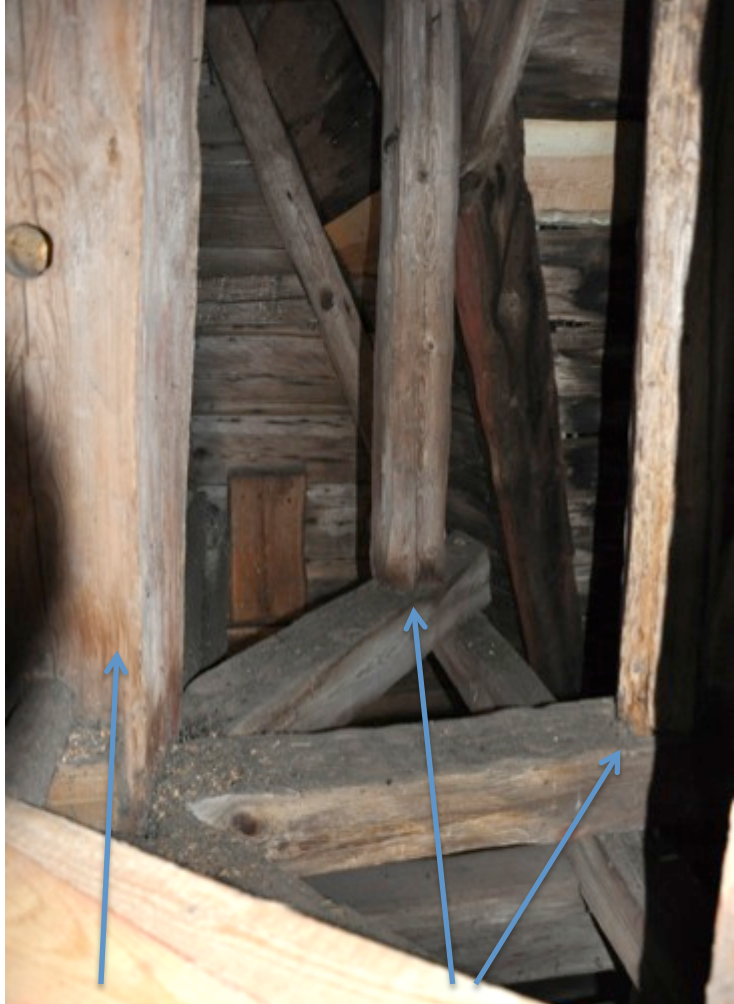
Mittmasten och två av sparrarnas möte med bjälkarna. Nedan ses knuten med tapp underifrån, rötskador.
